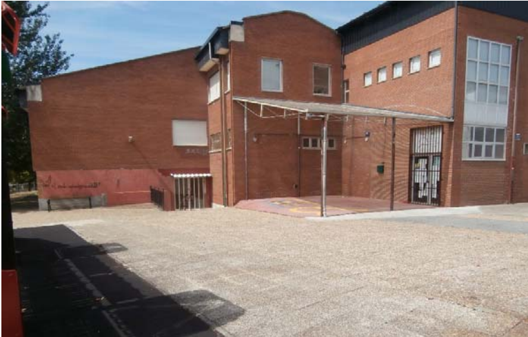
Vista de la entrada al colegio a cubrir, con cubierta actual a retirar
